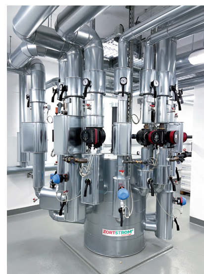
Heizung Krankenhaus Kaufbeuren
